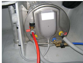
ballon d'eau chaude
