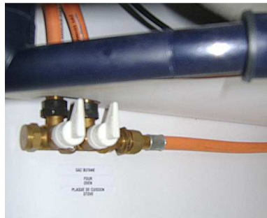
Vannes derrière le tiroir
