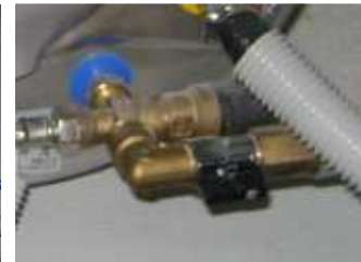
vanne du ballon d'eau chaude
